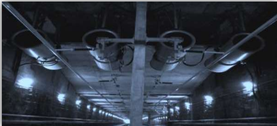
Tunnel Booster Fan
